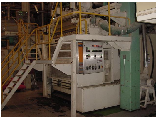
Foto1: planta de alimentos, panel de control
