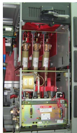
Equipo para Arranque Motor.
