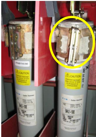
Accesorio en falla
